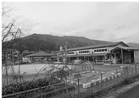
老朽化が目だつ片山保育園・園舎
