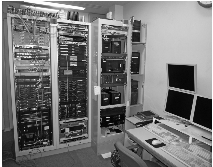
大量のデータが保存されているサーバー （池田町役場情報政策室）
