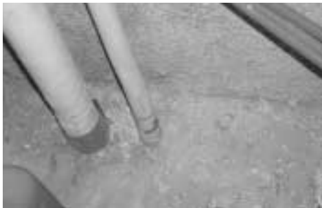
はがれた石綿(保健センター・機械室)
