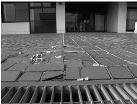
中央公民館テラスのレンガはがれ
