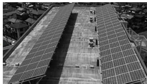
屋上設置型ソーラーパネル
