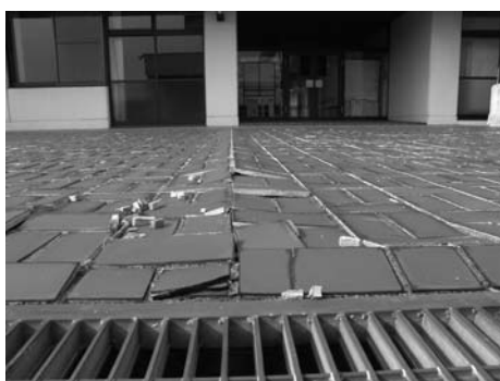
中央公民館テラスのレンガはがれ
