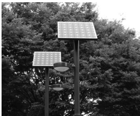
総合体育館駐車場設置のハイブリッド防犯灯
