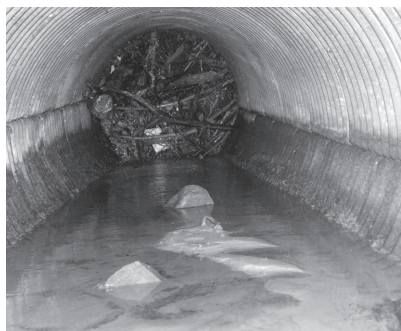
流木が堰き止めた（下流側より）
