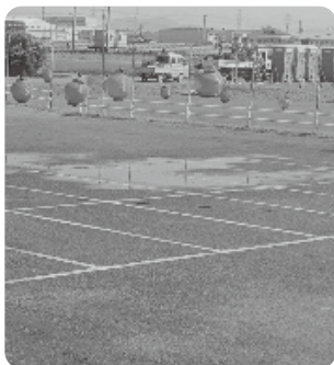
水の処理に苦労した駐車場
